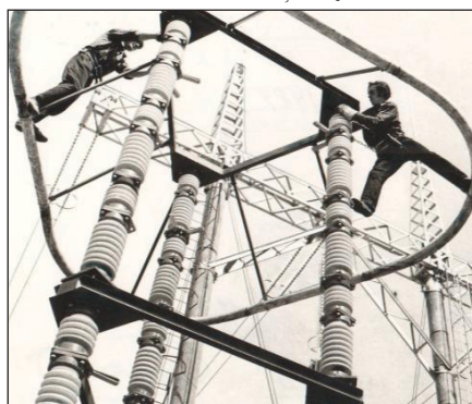
Foto 10. Montarea echipamentului de înaltă tensiune, 1988 [15, f.14].
